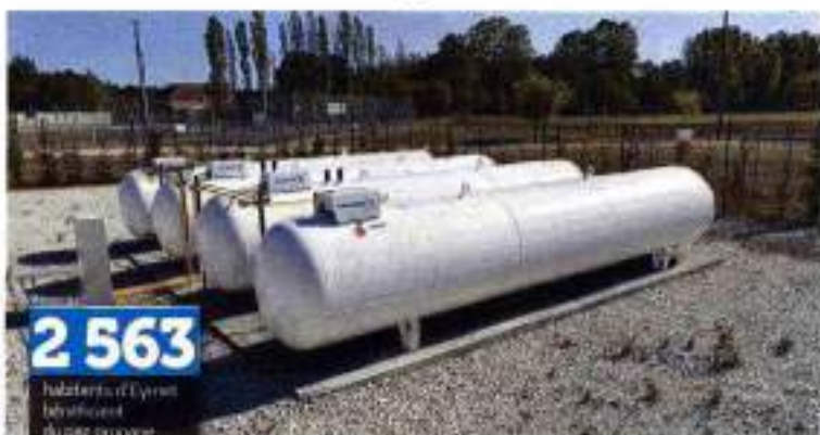
Quatre citernes aériennes constituent le stockage le plus important et assurent la desserte d'une dizaine de rues.
