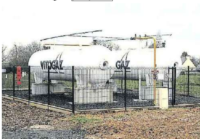
Les deux réservoirs de gaz propane de Lanvollon alimentent le réseau communal à proximité du terrain des sports.
